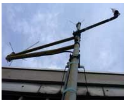
De antennes van de repeaters
